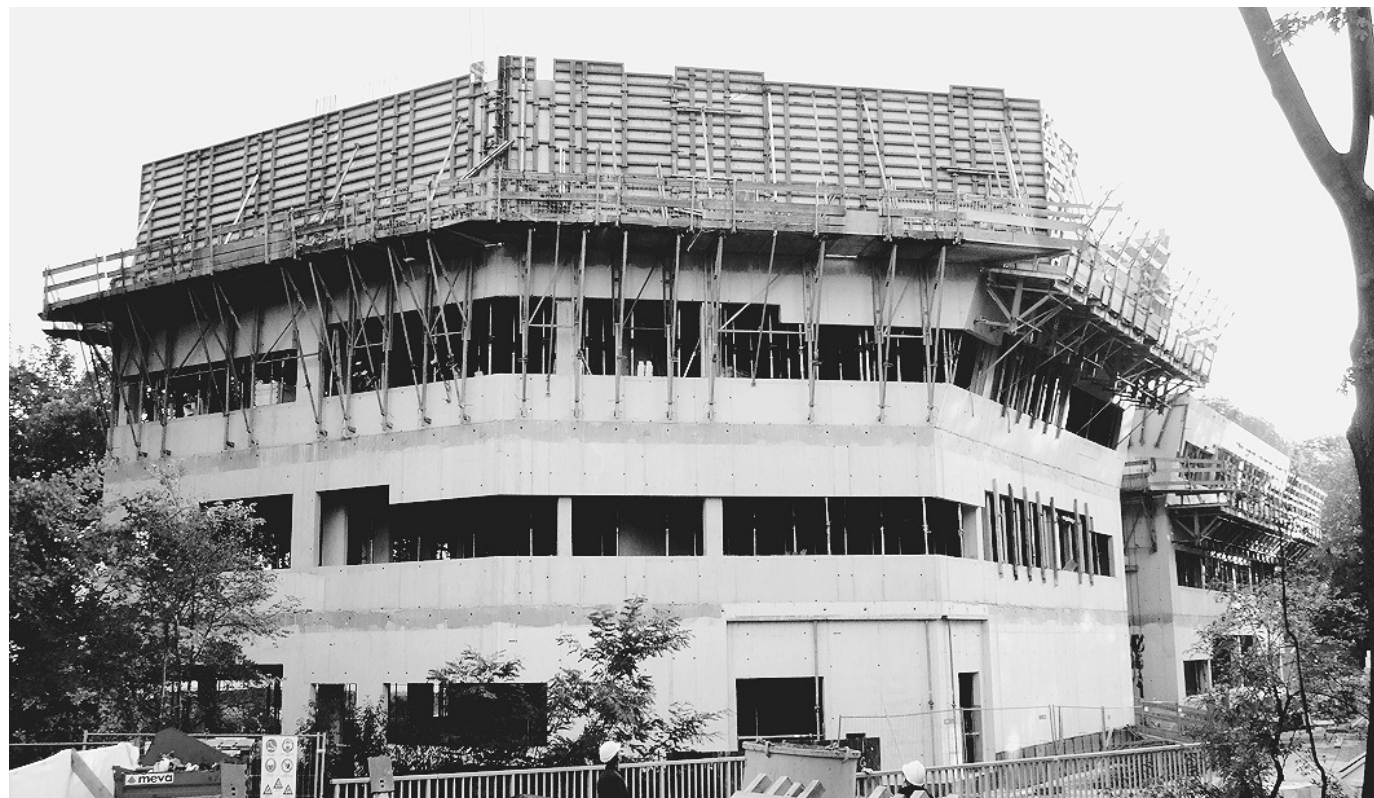
Auf den abgeschrägten Stirnseiten des Laborgebäudes steht die Wandschalung Mammut 350 auf der Arbeitsbühne LAB 190. An der geneigten Längswand – im Foto rechts – steht sie auf dem geneigten Klettergerüst KLK 230. Fotos: Meva
